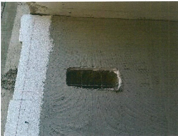
Fotografía N° 21, 03-07-2015, pasada en muro de los ejes D- D1 con eje 38, ejecutadas luego de hormigonar.
