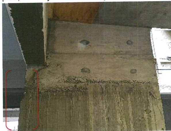
Fotografía N° 5, 24-06-2015, vista general de la deformación en el muro ubicado en eje D2 con la intersección del eje 9.
