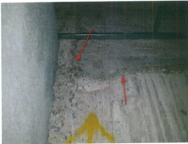
Fotografía N° 13, 03-07-2015, juntas de construcción mal ejecutadas en muros del eje H1, entre los ejes 7a y 8.
