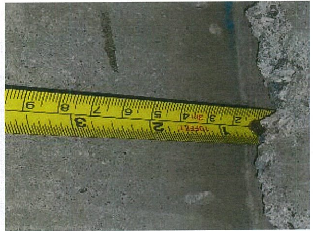
Fotografía N° 8, 24-06-215, deformación entre 1 y 1,5 cms, en muro del eje K con la intersección de eje 11.
