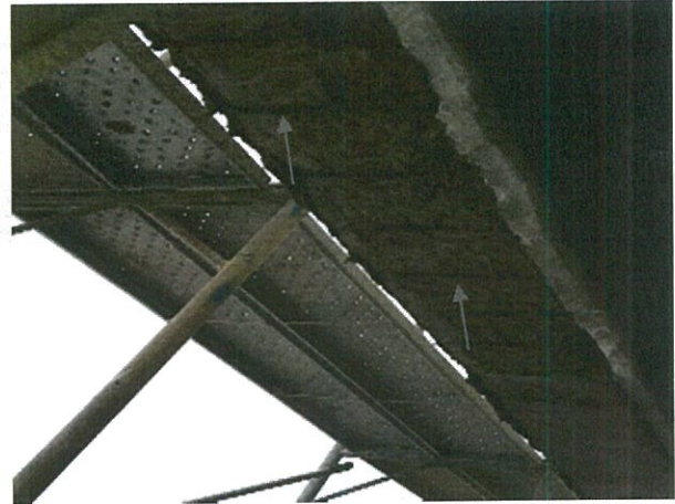
Fotografía N° 2, 30-06-2015, viga con enfierradura a la vista, ubicada en segundo piso en el eje D entre los ejes 30 y 34.
