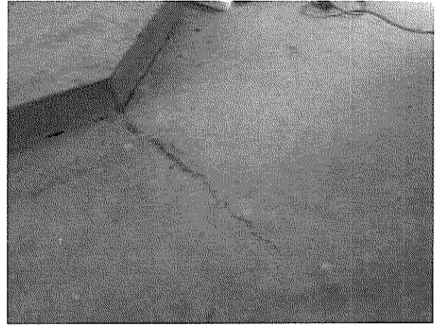
Fotografía N° 38, 13-07-2015, sobrelosa fisurada en salas de segundo piso.
