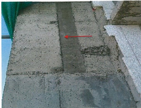
Fotografía N° 11, 23-06-215, intersección de muros ejes D1-38,39.
