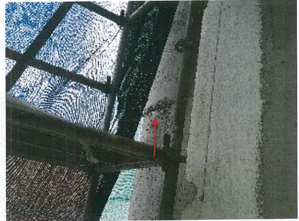
Fotografía N° 12, 23-06-215, intersección de muros ejes D1-38,39.
