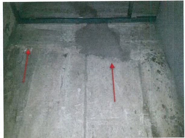
Fotografía N° 14, 03-07-2015, juntas de construcción mal ejecutadas en muros del eje H1, entre los ejes 6a y 7a.
