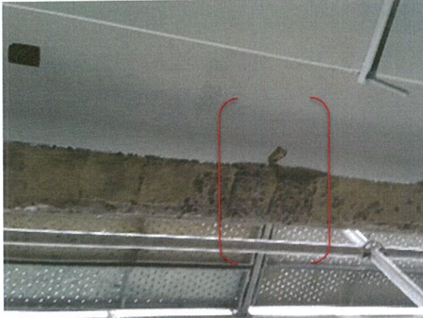
Fotografía N° 1, 30-06-2015, viga con enfierradura a la vista, ubicada en segundo piso en el eje D entre los ejes 23 y 24.
