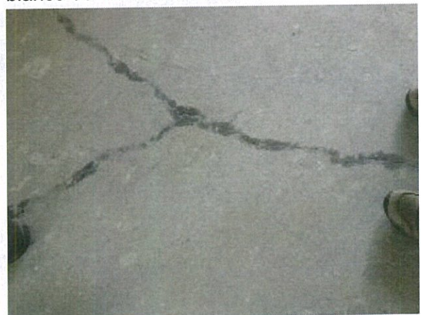
Fotografía N° 36, 13-07-2015, sobrelosa fisurada en salas de segundo piso.
