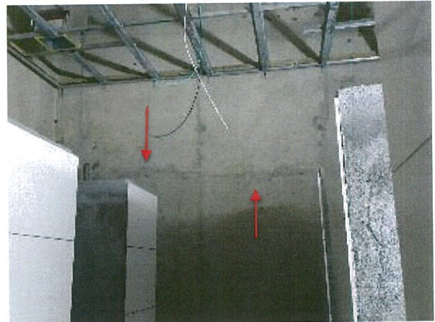
Fotografía N° 16, 03-07-2015, juntas de construcción mal ejecutadas en muro de eje 33 entre los ejes U y V.
