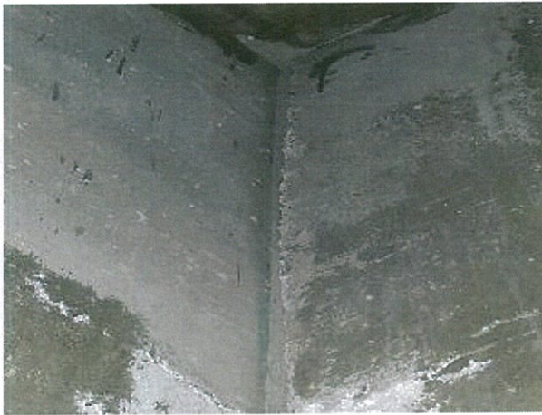
Fotografía N° 7, 24-06-215, deformación en muro del eje 11 con la intersección de eje M.
