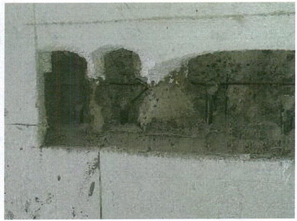
Fotografía N° 20, 03-07-2015, picadas en el muro del eje T, entre los ejes 31 y 37.
