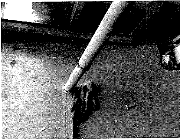
Fotografía N° 27, 03-07-2015, fisuras en radiador de auditorio, eje 21.
