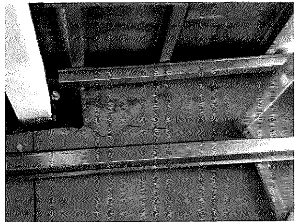
Fotografía N° 26, 03-07-2015, fisuras en radiador de auditorio, eje 21.
