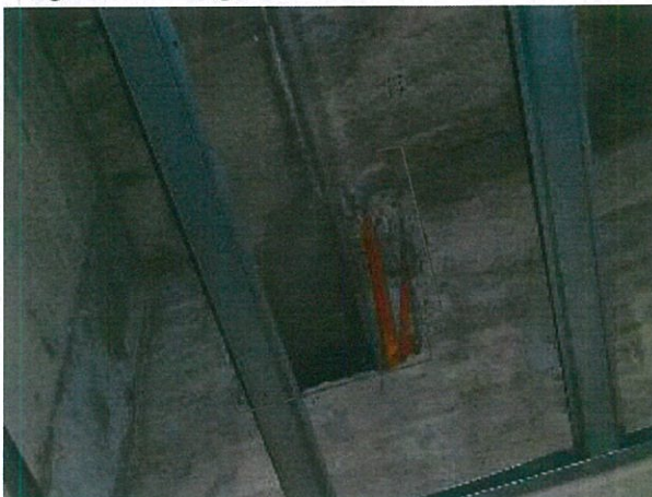
Fotografía N° 23, 24-06-2015, pasada en muro ubicado en eje 6a con eje H1.
